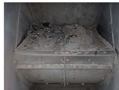
主灰排出装置の状況（一部閉塞解除後撮影）
